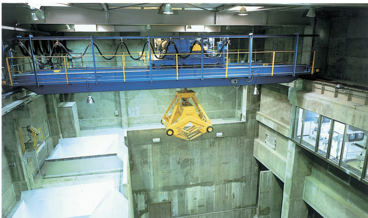
▼ごみピット及びごみクレーン
