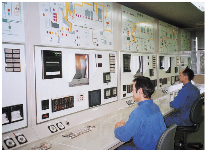
中央制御室（コントロール室）
